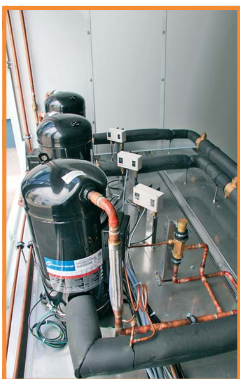
Kompresori Compressors Компрессоры
